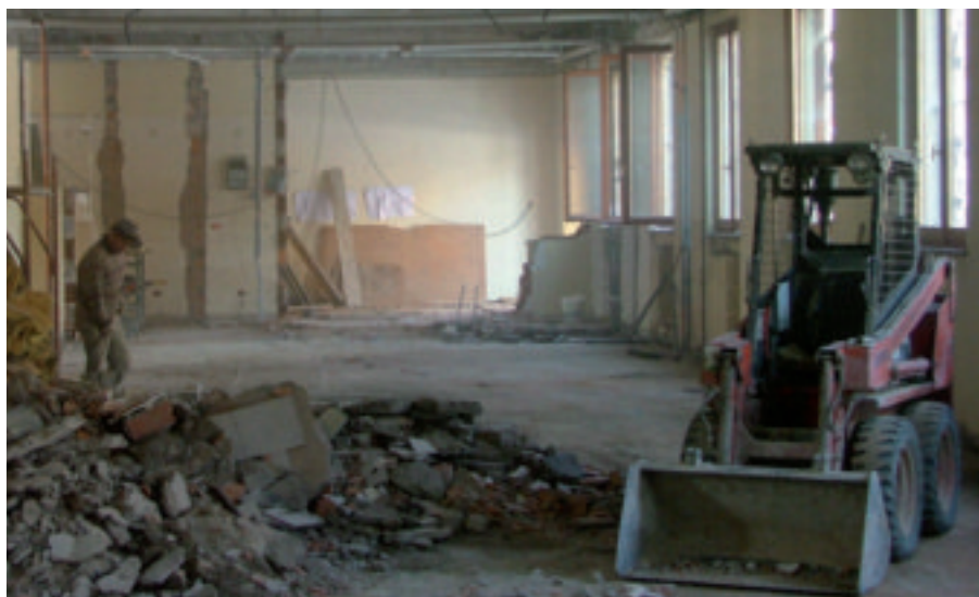
Lavori in corso al Convento dei Cappuccini di Piazzale Velasquez che ospiterà l'ambulatorio di OSF
