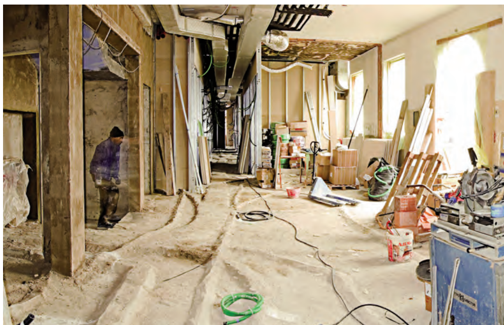
Avanzano rapidamente i lavori per la realizzazione degli ambienti e delle strutture di accoglienza nella nuova sede dell'ambulatorio di OSF
